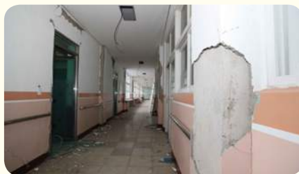
건물 내부 벽체 파손
